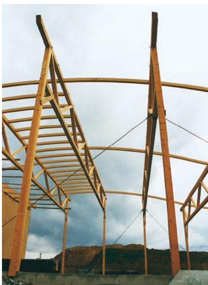
Bild 13: Bei der Montage wurden die Fachwerkriegel seitlich gegen Umkippen mit Greifzügen abgespannt.
