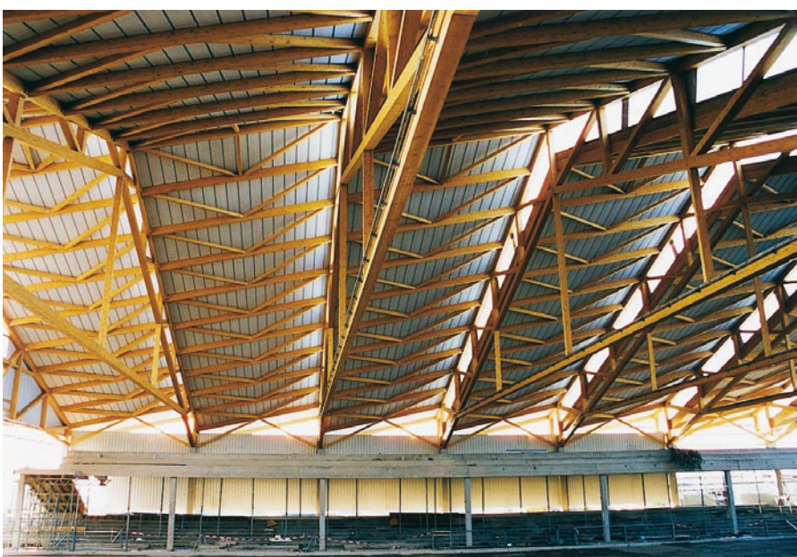
Bild 11: K-Verbände aus BS-Holz dienen der Aussteifung des Daches und ergeben zusammen mit den Oberlichtern ein reizvolles Formen- und Lichtspiel.
